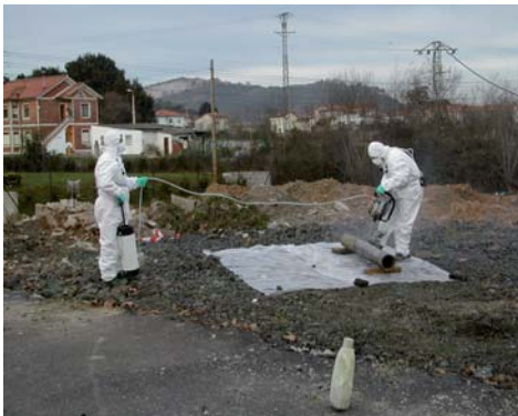
Figura A3.3 Ensayo de distintas herramientas de trabajo para corte de tubería. La colocación de una lámina de plástico en el suelo evita la diseminación de los residuos y facilita su recogida y limpieza de la zona
