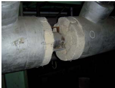
Figura A1.30 Detalle de calorifugado (coquilla)
