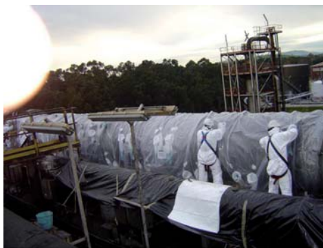
Figura A3.14 Colocación de los sacos de guantes para trabajar en una tubería
