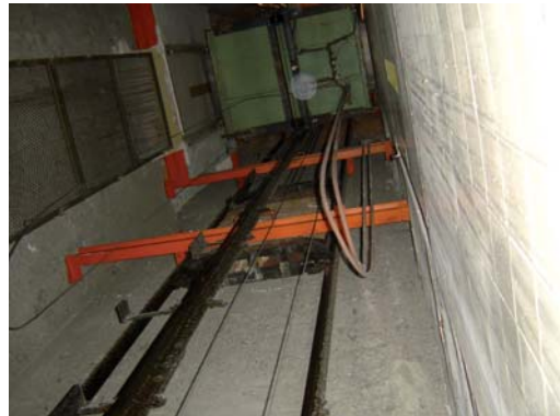
Figura A1.15 También se han encontrado aunque más raramente sobre hormigón (pared interior en el hueco de ascensor) y en la cara interna de algunas cubiertas
