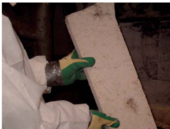
Figura A3.21 Retirada de bloques enteros de MCA friable, uno a uno, de un aislamiento térmico
