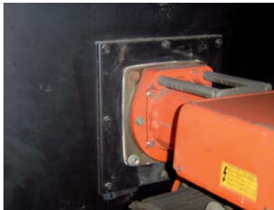
Figura A1.33 Junta en el quemador de una caldera
