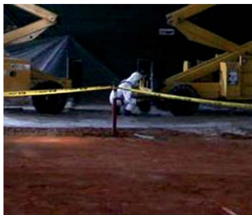
Figura A3.1 Limitación de la zona de trabajo para la retirada de una cubierta de fibrocemento
